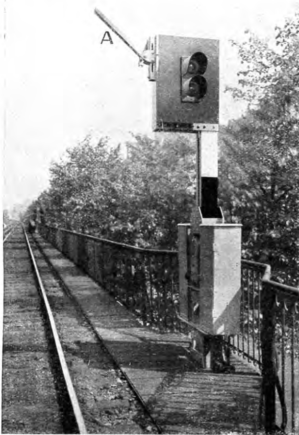
Abb. 8. Tageslichtsignal der Berliner Hochbahn mit Fahrsperrrenarm (A).
