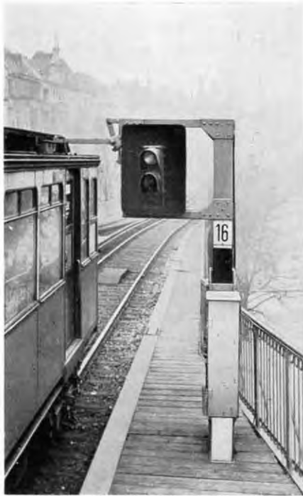
Abb. 19. Signal und Fahrsperrre in Haltstellung.
